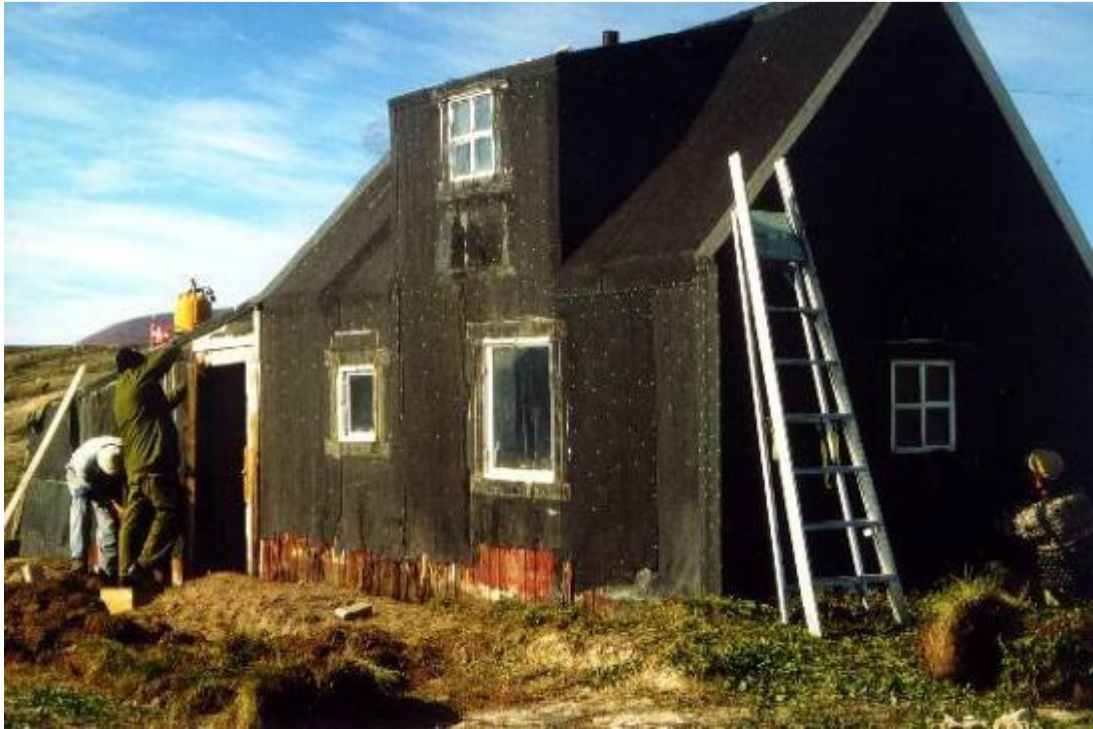
Ovenfor: Sydsiden af Hoelsbu trængte kraftigt til en istandsættelse.
