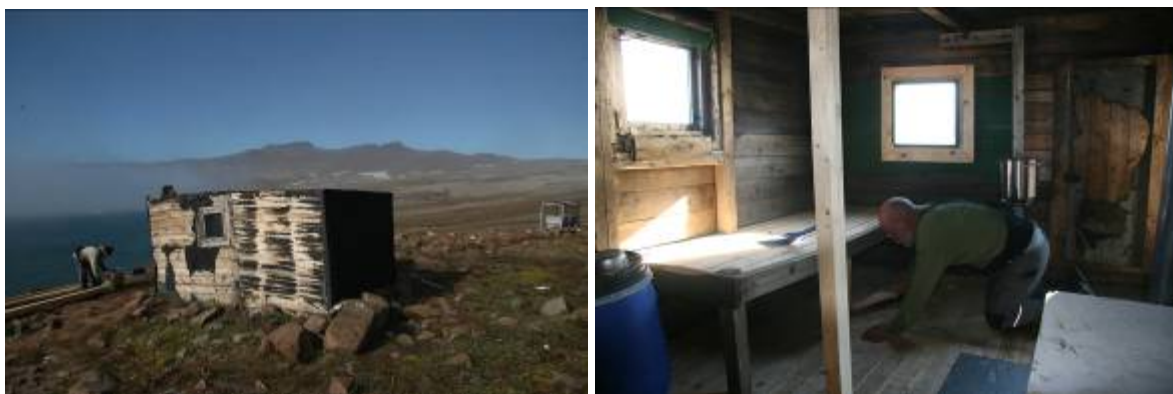
Dahl Skær hytten [412] før og under renoveringen. Der blev lagt nyt gulv i hytten oven på det eksisterende gulv.
